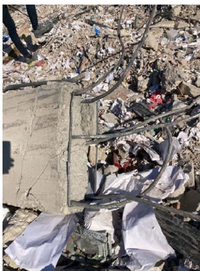
Рис. 2. Фрагмент колонны на месте разрушения [8]
